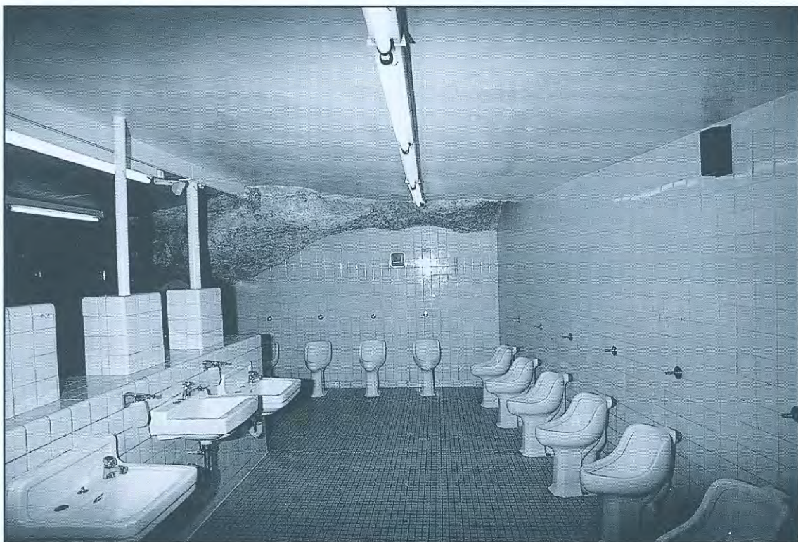
fig.9 Toilettes (maschili) attrezzate all'interno delle Carlsbad Cavern's (New Mexico-USA) nelle vicinanze degli "stores" e del ristorante sotterraneo. Foto Mauro Chiesi.
