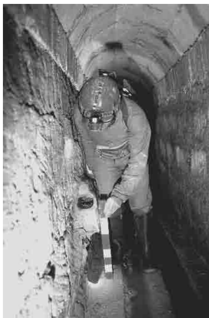
Figura 10 - Resti della pre-esistente conduttura in terracotta, tranciata dalla realizzazione della galleria (Foto: M. Traverso).
