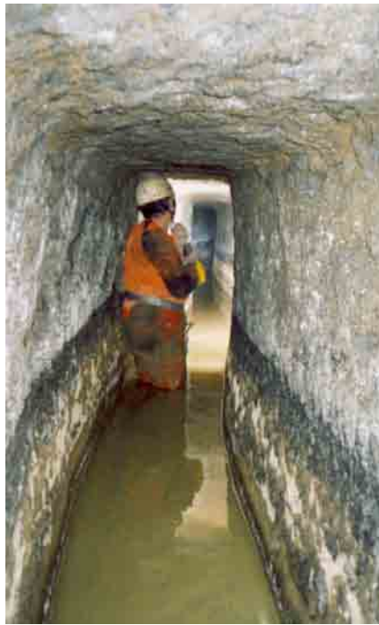
Figura 5 - Tratto dell'acquedotto del Carmignano parzialmente allagato (Foto R. Varriale).
