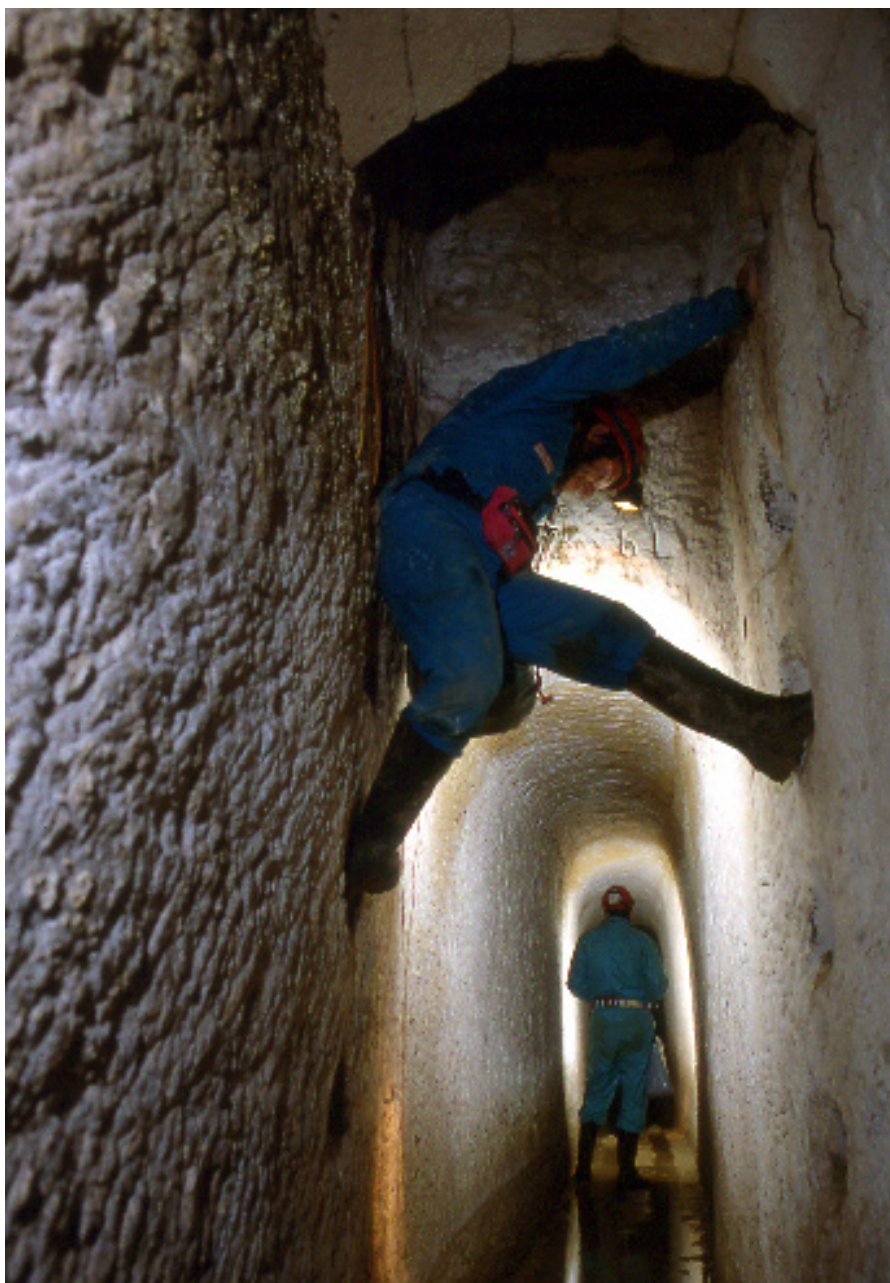
Figura 8 - Tratto di galleria scavato nella roccia viva, tra la Grotta della Fonte (punto G in Figura 1) e il Partitore. Da notare le pedarole per scendere dal pozzo di ispezione che collega alla superficie (Foto: M. Traverso).
