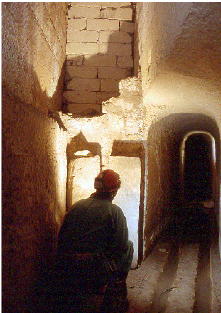
Figura 9 - Evidenti fasi di ampliamento del condotto con approfondimento della trincea e prosecuzione a valle in una galleria scavata nella roccia viva (Foto: G. Bologna).
