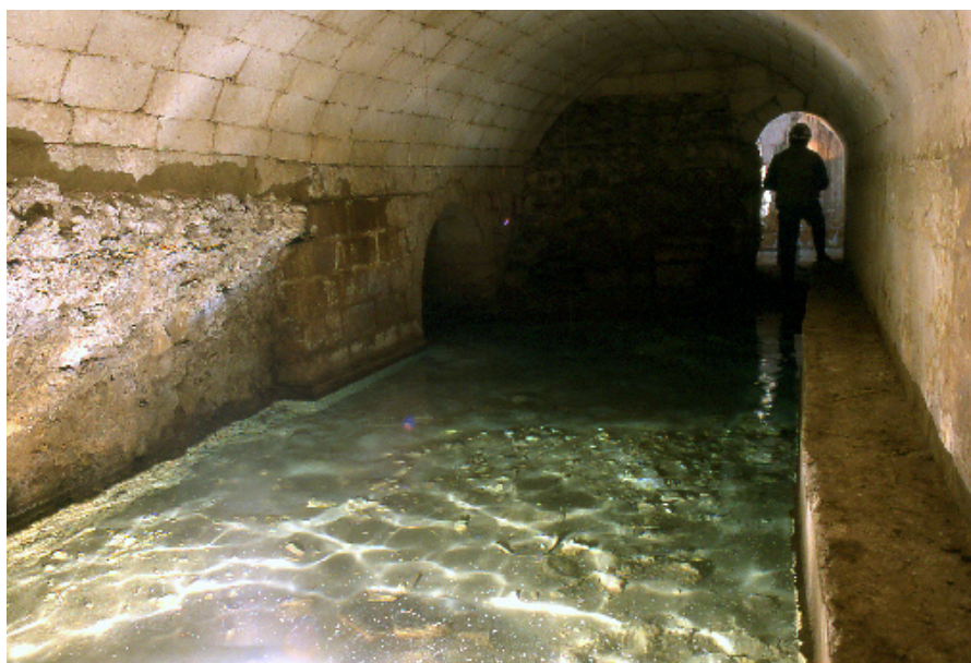
Figura 5 - Vasca di accumulo nell'edificio semi-sotterraneo della Presa (Foto: M. Traverso).
