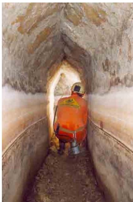
Figura 4 - Tratto dell'acquedotto della Bolla con pareti intonacate e volta a cappuccina (foto R. Varriale).
